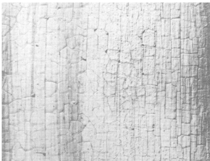
Рисунок 2 — Растрескивание лакокрасочного покрытия
